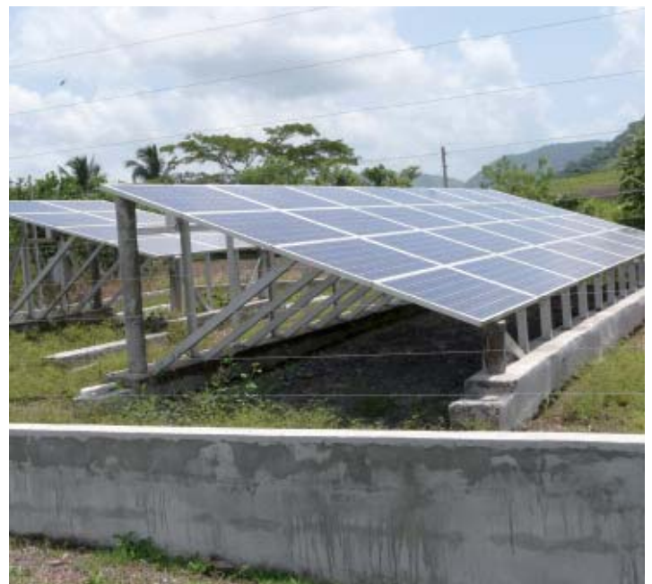
Placas solares alimentan la instalación
